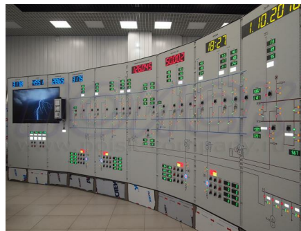
Г) Мнемощит (в последние годы заменены на экраны).
